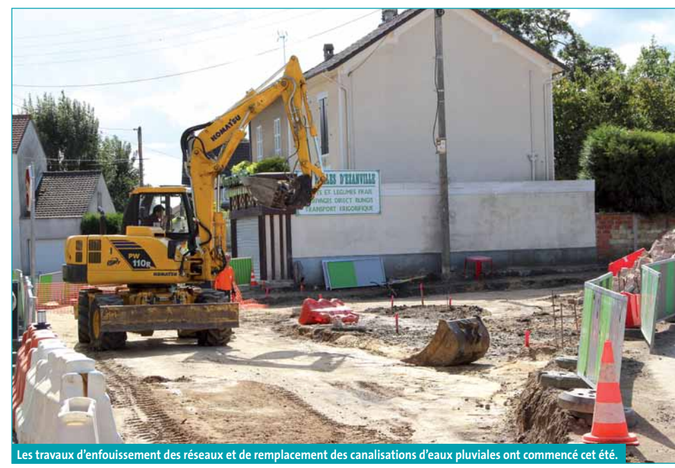
Les travaux d'enfouissement des réseaux et de remplacement des canalisations d'eaux pluviales ont commencé cet été.
