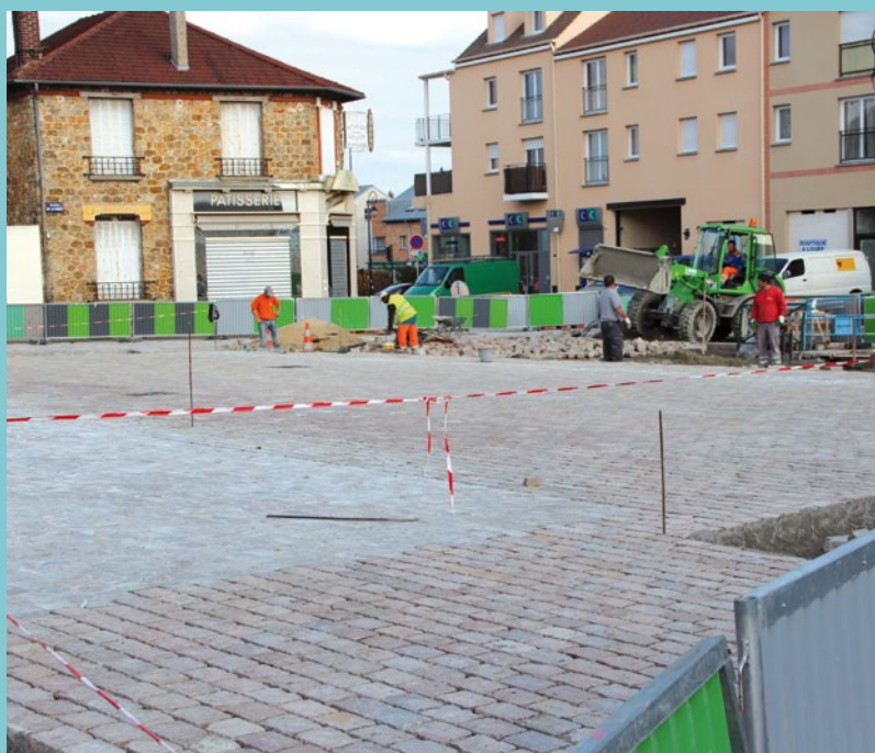
▲ Le plus gros des travaux de la place Elluin Devillers sera terminé à la fin du mois. Un éclairage public provisoire sera ensuite installé par la CCOFP.
